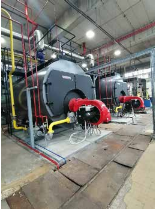
Два нова котла
